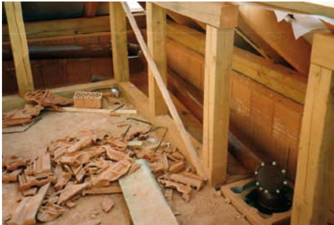
Bild 4: Diese „wilde“ Verlegung einer Kunststoffabgasleitung (PVDF) ist zwar platzsparend, zeigt aber eine ganze Hand voller Mängel, wie den fehlenden Brandschutzschacht im OG und keine Demontagemöglichkeit
