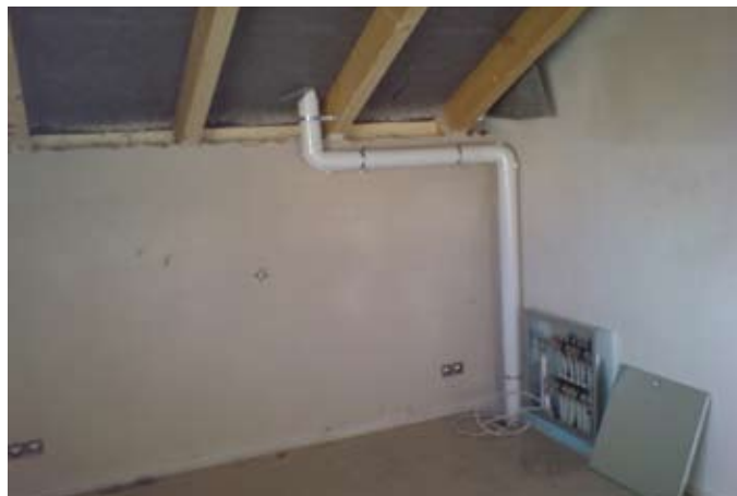
Bild 7a und b: eine klassische „Wildwest-Installation“ – dem Auftraggeber wird ein sachmangelfreies Werk geschuldet, was hier nicht erfolgte: fehlende einfache Demontagemöglichkeit, ...
