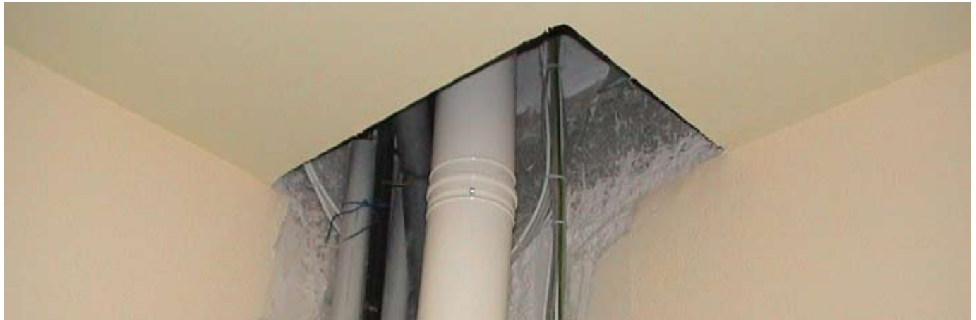
Bild 6: Sachmangelbehaftete Installation: eine Abgasanlageninstallation, die nicht den Regeln der Technik entspricht
