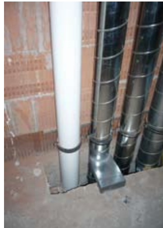
... nach Fertigstellung des Bauprojekts ist eine Demontage der Abgasleitung nur mit großem Aufwand möglich
