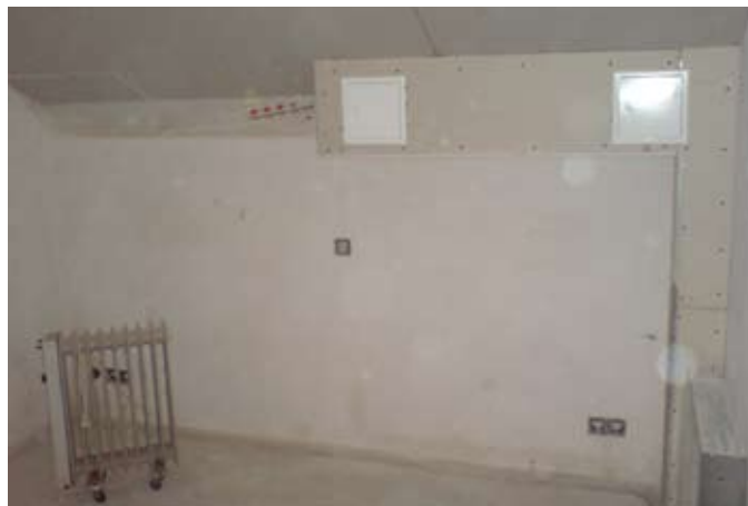
... fehlendes Gefälle, Revision im Bogen mit stehendem Kondensat und Gipskartonverschlage sind fur diese Anwendung nicht klassifiziert
