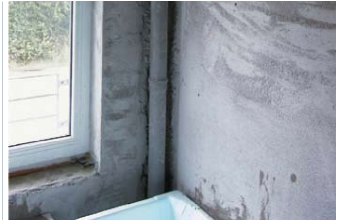
Bild 1: Einwandige Leitung platzsparend hinter der Badewanne kraftschlüssig per Schelle in einer Raumecke installiert. Da sind Hinterlüftung, Brandschutz, Längendehnung und einfache Demontagemöglichkeit Fehlanzeige
