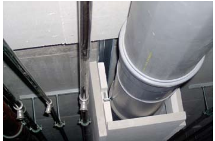
Bild 3: Bei dieser einwandigen Abgasleitung mit kraftschlüssiger Schellenverbindung wurde die erforderliche Längendehnung ( \Delta T = 70 \text{ K} : 1,1 \text{ cm/m} ) missachtet; zudem gibt es keine Demontagemöglichkeit durch die Konstruktion und die Schachtverkleidung ist mangelhaft
