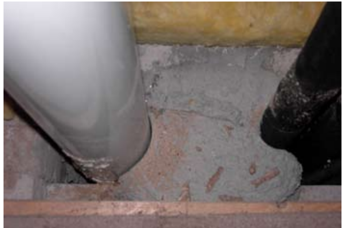
Bild 5: Eine klassische Gewährleistungsfall: eine doppelwandige Abgasleitung ohne klassifizierten Abgasschacht; die Betonierung im Deckenbereich führt im Fall des Falles zu einer höchst aufwendigen Demontage
